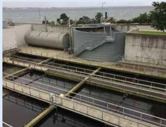
Biogas- og rådnetank
