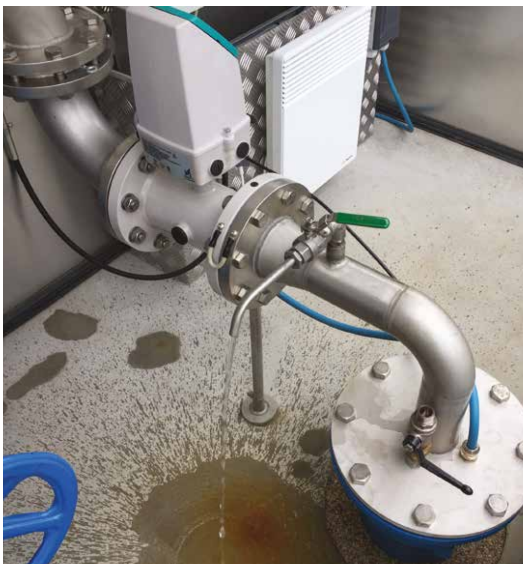
Inde i borehusene kan man tappe råvand til testning og smagsprøver. Dette vand har ikke set dagslys i over 50 år.
