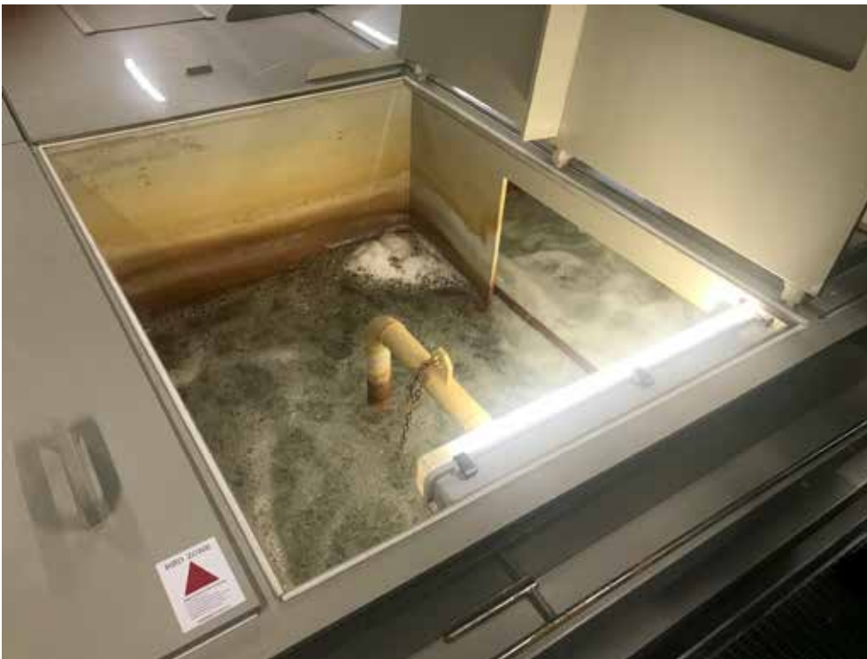
Iltning af råvand foregår i lukkede tanke med udsugning af gasser som svovlbrinte og metan.
