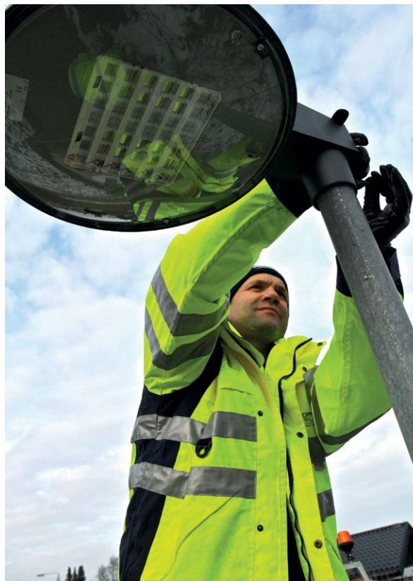
Forsyning Helsingør fortsatte i 2013 udskiftningen af gadelyset til LED-teknologi.
