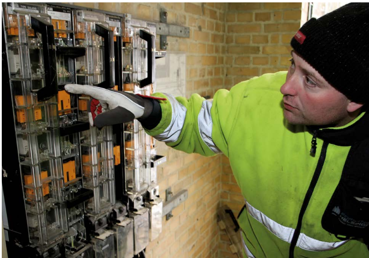
Forsyning Helsingør arbejder løbende med driften og vedligeholdelsen af el-nettet. Her er det en transformerstation, der vedligeholdes.
