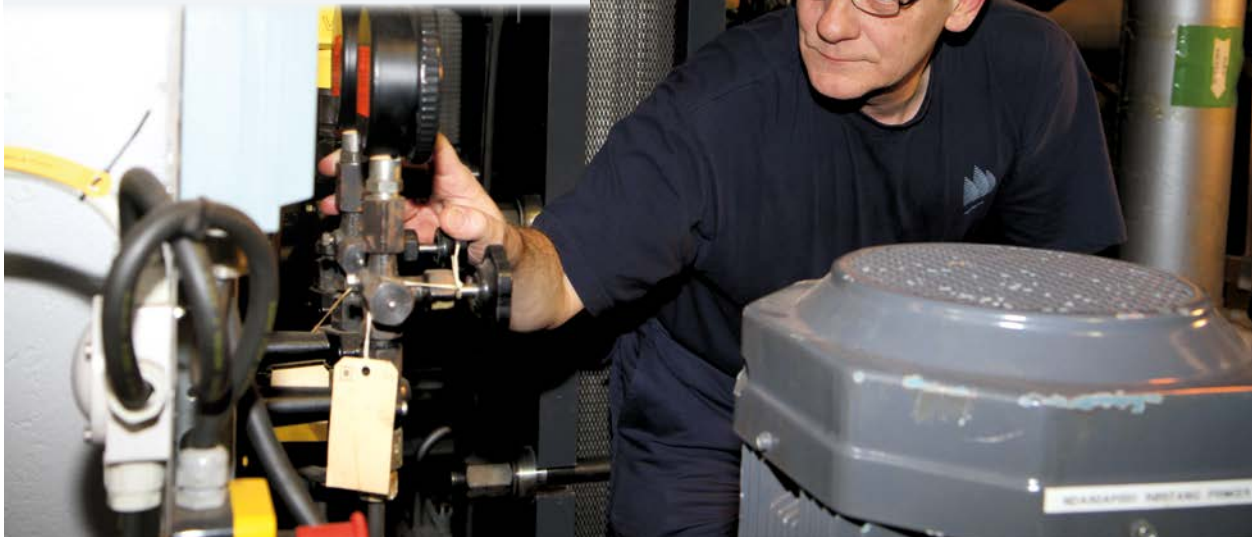
Helsingør Kraftvarmeværk installerede i 2012 nye Low NOx-brændere, som reducerer udledningen af NOx-gasser fra ca. 300 tons om året til ca. 52 tons om året.
