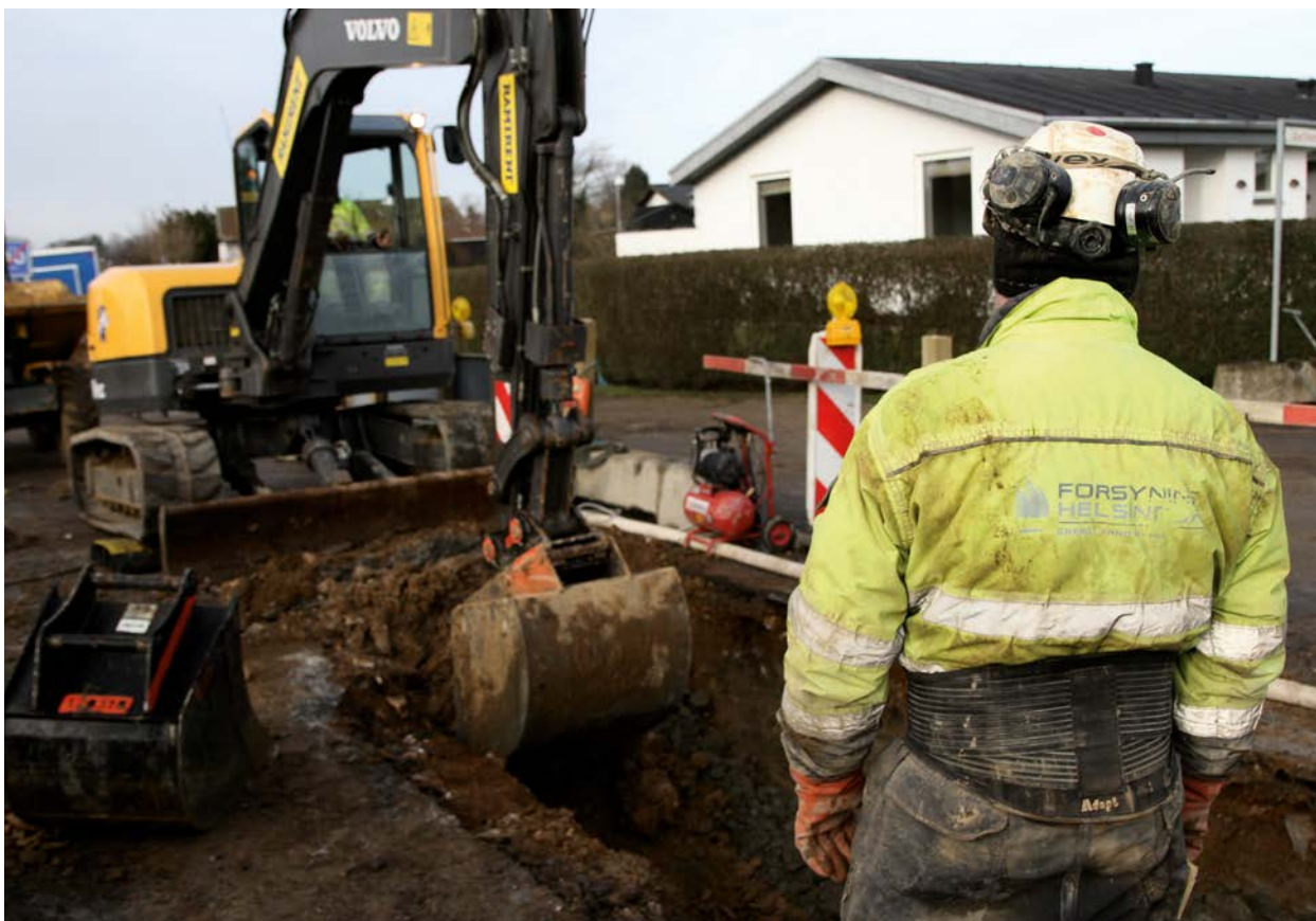
Arbejdet med klimatilpasningen af kloakker og regnvandsbassiner er først lige begyndt og vil fylde meget de kommende år.
