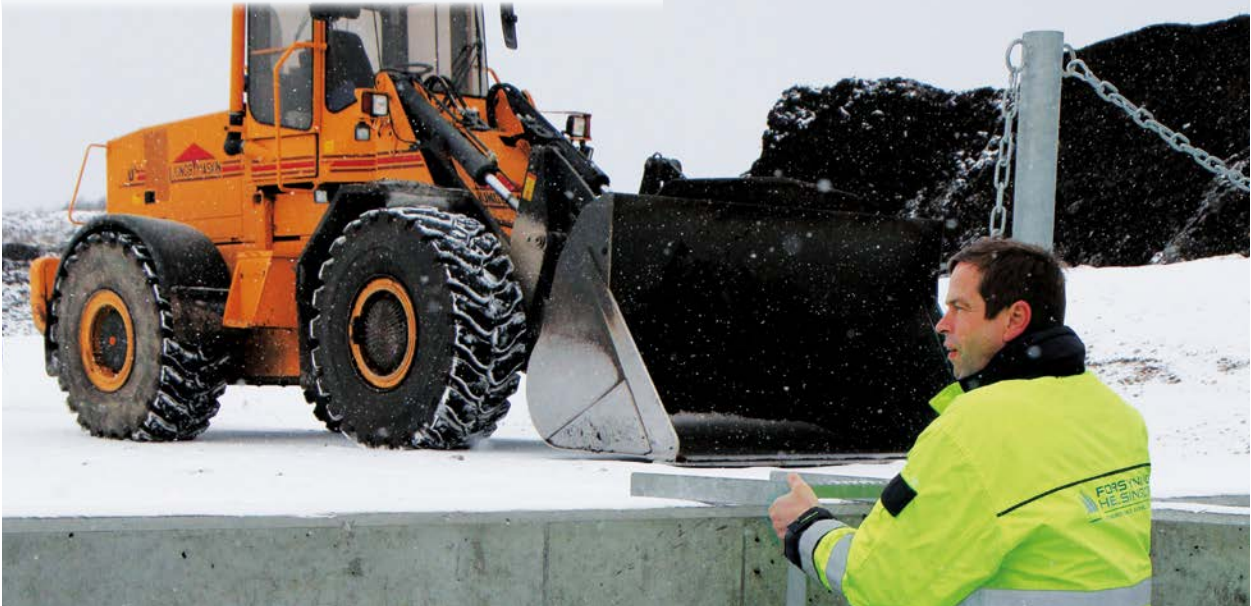
Skibstrup Affaldscenter byggede i 2012 et nyt slambassin til behandling af slam fra fx vejbrønde. Slambassinet bliver sat i drift i løbet af 2013.
