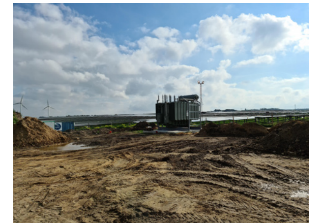
Foto af transformator i anlægsfasen
