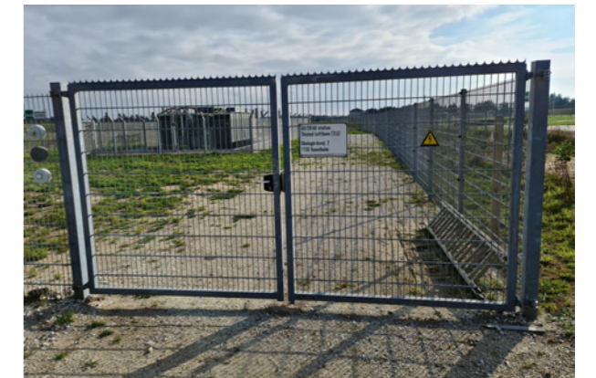
Eksempel på fritstående transformator og hegn.
