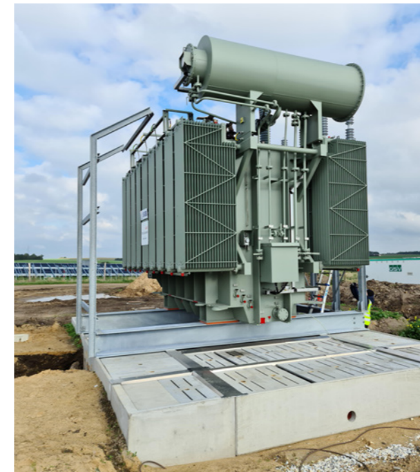
Eksempel på fritstående transformator.
